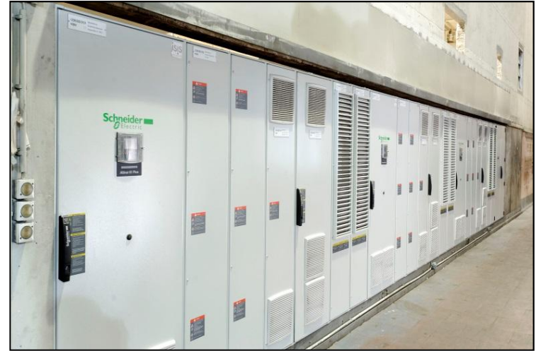
• Frequenzumrichter Schaltschränke für Druckerhöhungspumpen
